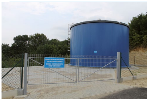
Zbiornik na wodę V-200m 3
